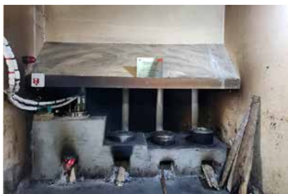
Lò đun nước nóng cho một số trường tiểu học vùng cao của tỉnh Lào Cai do Dự án KIPA xây dựng.
